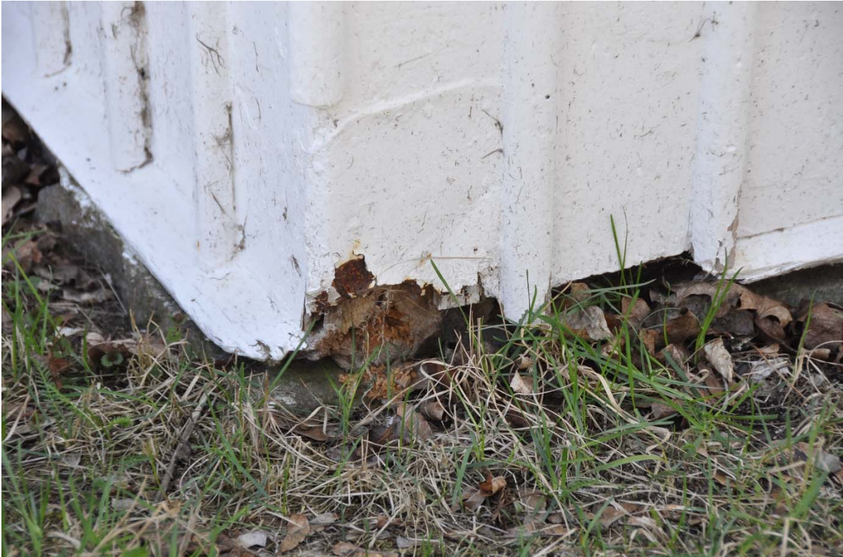
Här framgår med all önskvärd tydlighet att syllen är rötskadad.
